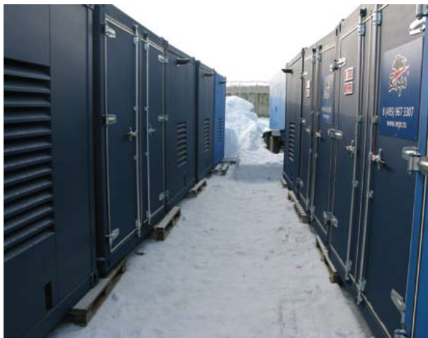
Электроагрегаты АДС 180-Т400РП в контейнерах "Север 5"
